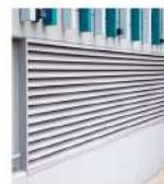
14. Ô chớp thông gió. Ventilation doors.
